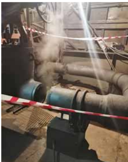
Рис. 19. Общий вид места аварии
