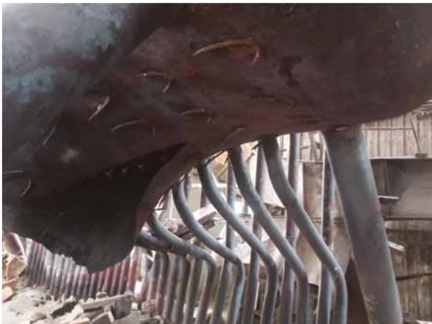
Рис. 14. Разрушенный барабан котла
