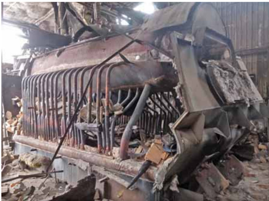
Рис. 13. Общий вид разрушенного парового котла
