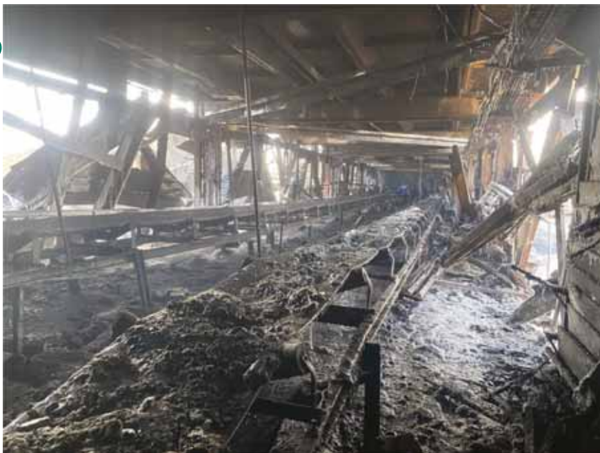
Рис. 17. Последствия аварии в помещении топливоподачи
