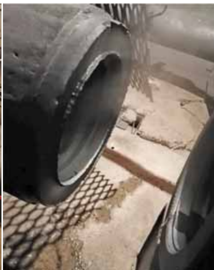
Рис. 20. Разрушенный сварной шов
