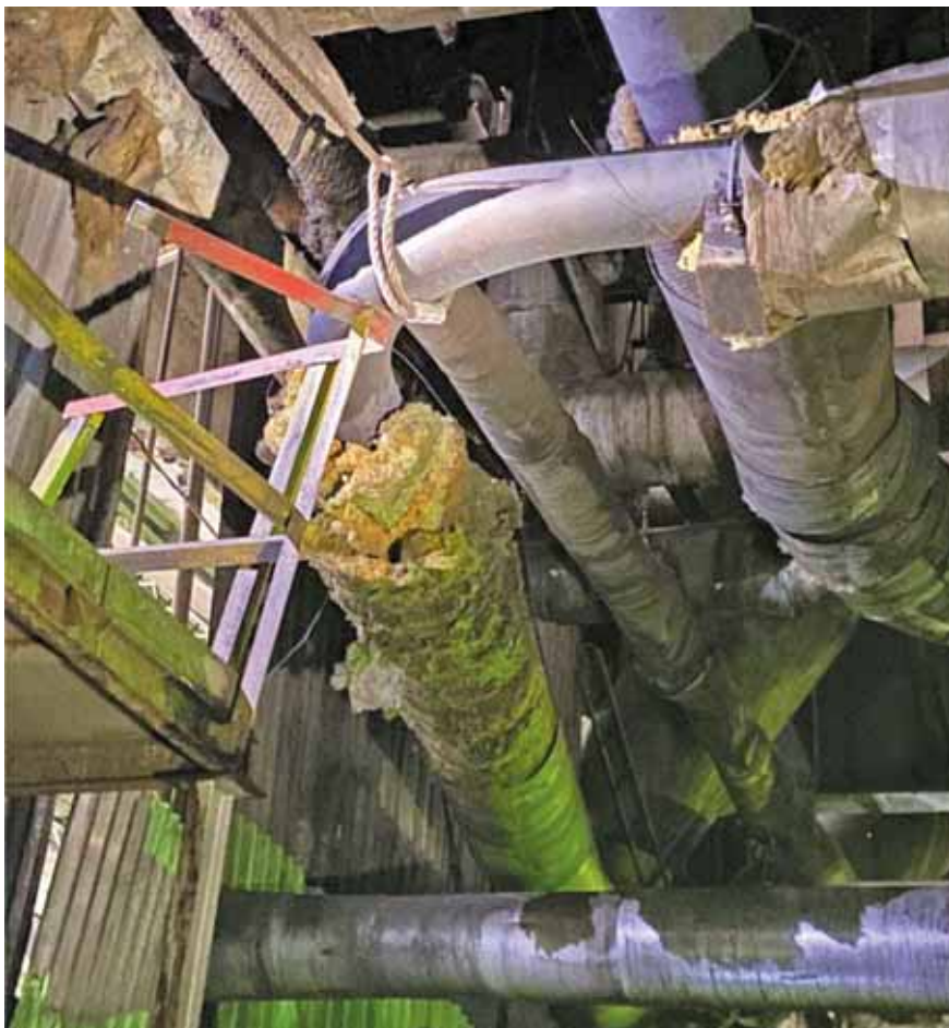
Рис. 21. Раскрывшийся гиб паропровода
