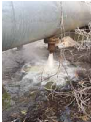
Рис. 8. Дренажный штуцер магистрали тепловой сети с сорванным крапом
