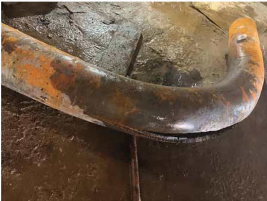
Рис. 12. Разрушенный гиб паропровода
