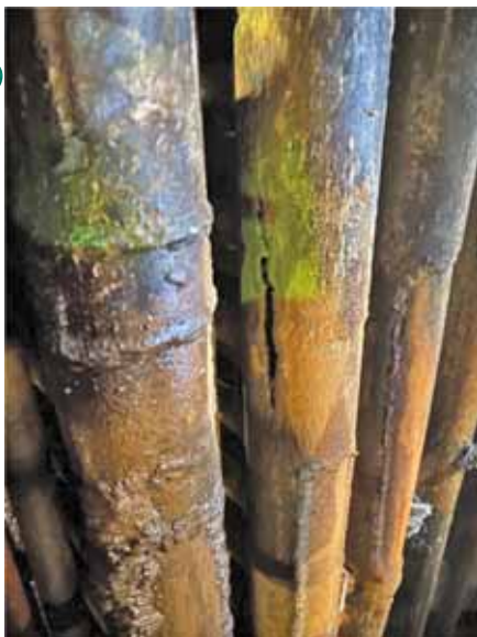
Рис. 9. Повреждения и восстановительный ремонт КВГМ-100 после разморозки
