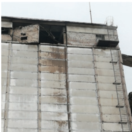
Рис. 26. Место происшествия (разрушение силосного корпуса)
