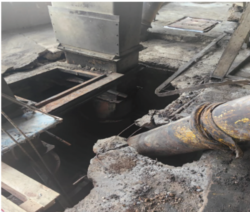
Рис. 20. Разрушения в цехе по производству комбикормов
