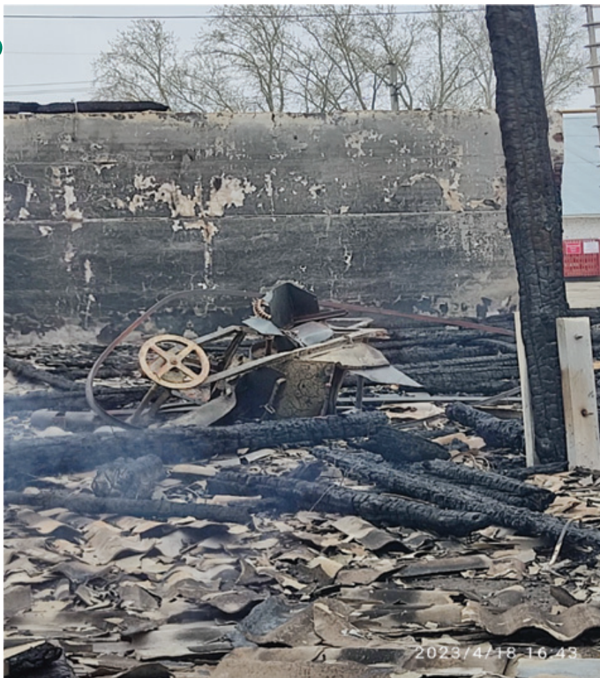
Рис. 14. Разрушенные технические устройства (ленточный конвейер, вентилятор)
