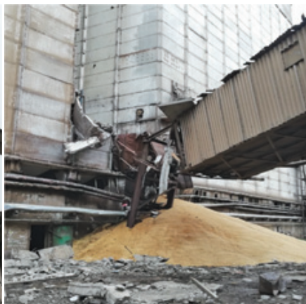
Рис. 27. Место происшествия (разрушение силосного корпуса и галереи)
