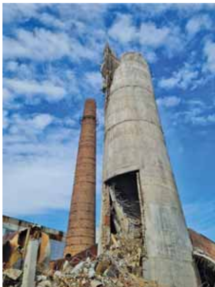
Рис. 8. Разрушение дымовой трубы
