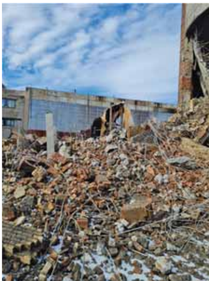
Рис. 9. Разрушение дымовой трубы
