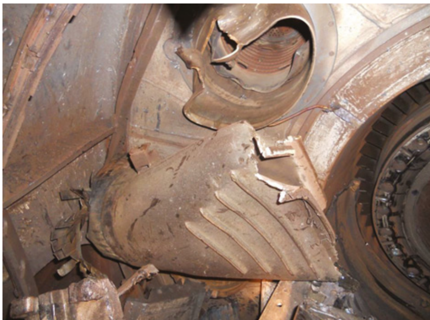
Рис. 22. Разрушенная турбина ГТУ-1
