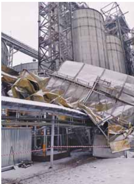
Рис. 15. Место происшествия: обрушенная шахта зерносушилки
