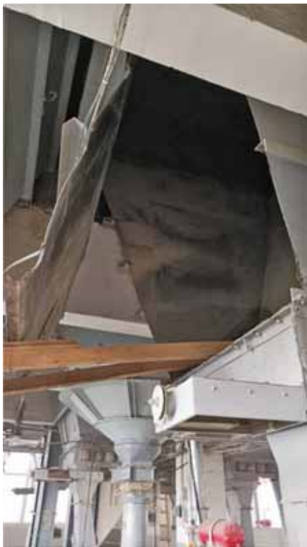
Рис. 13. Разрушение стенки конуса силоса
