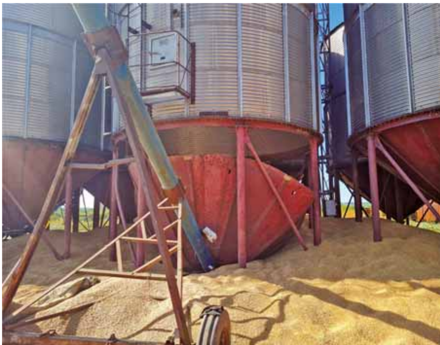
Рис. 11. Обрушение конуса дна силосной емкости ОПО «Склад силосного типа»
