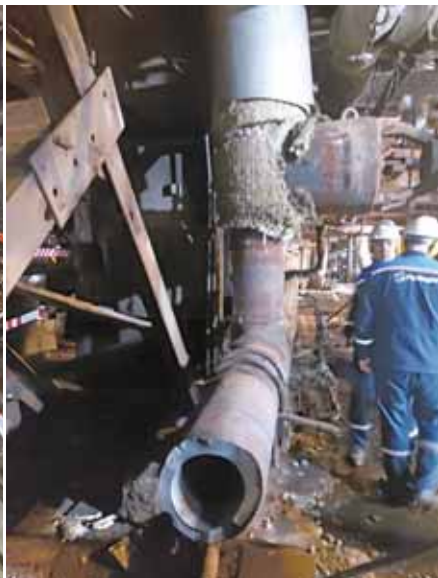
Рис. 23. Участок трубопровода в зоне разрушения трубопровода
