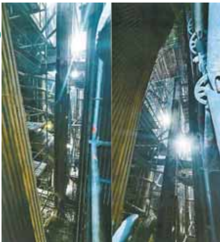
Рис. 17. Внутренний осмотр СРК-2, отм. 14.00, угол «фронт-левый экран». Повреждения экранов котла СРК-2
