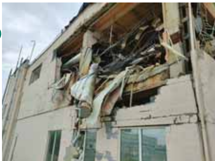
Рис. 11. Повреждение здания после аварии
