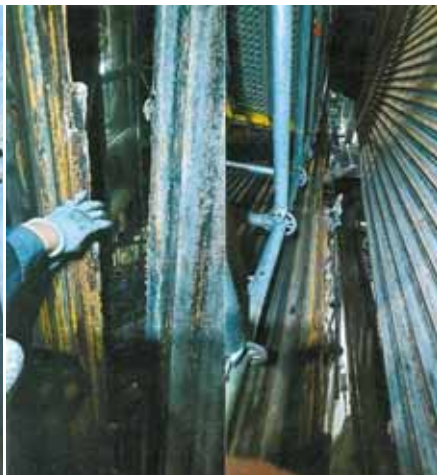
Рис. 18. Внутренний осмотр СРК-2, отм. 14.00, угол «фронт-правый экран». Повреждения экранов котла СРК-2
