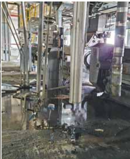
Рис. 2. Поврежденный вальцевой станок FR123
