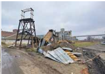
Рис. 10. Разрушенный ленточный конвейер
