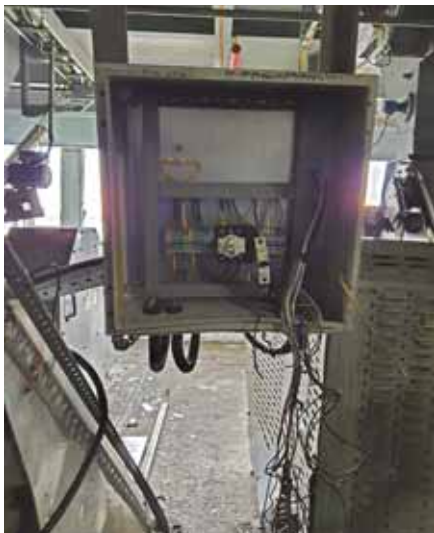
Рис. 1. Поврежденный ремонтный выключатель вальцевого станка FR123
