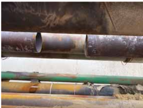
Рис. 18. Разрушенный паропровод Волжской ТЭЦ
