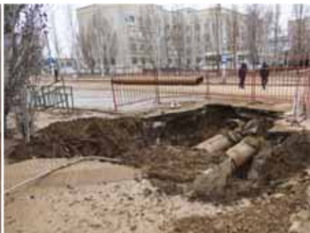
Рис. 9. Котлован на месте аварии трубопровода тепловой сети ООО «Волжские тепловые сети»
