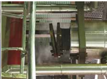
Рис. 17. Освобожденная фланцевая заглушка тупикового участка трубопровода
