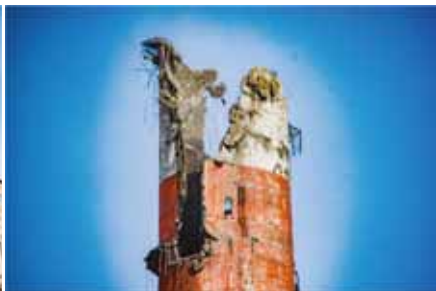
Рис. 13. Разрушенная дымовая труба
