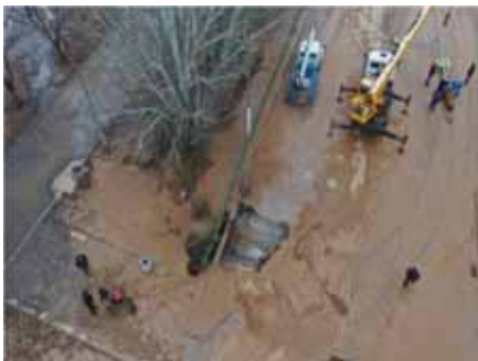
Рис. 8. Место аварии трубопровода тепловой сети ООО «Волжские тепловые сети»
