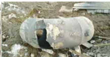
Рис. 11. Поврежденный секторный отвод трубопровода
