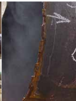
Рис. 19. Разрушенное сварное соединение трубопровода Волжской ТЭЦ
