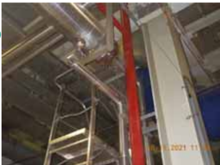
Рис. 16. Место происшествия, тупиковый участок трубопровода
